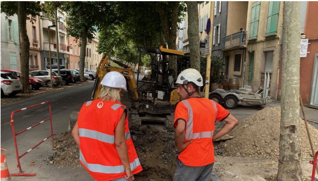
La fuite a été localisée au début du boulevard de La Capelle.
