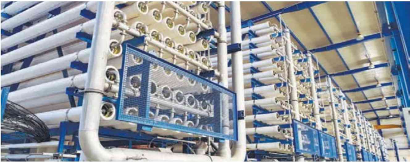
Imagen del interior de la desaladora Mar de Alborán, ubicada en Rambla Morales. LA VOZ
