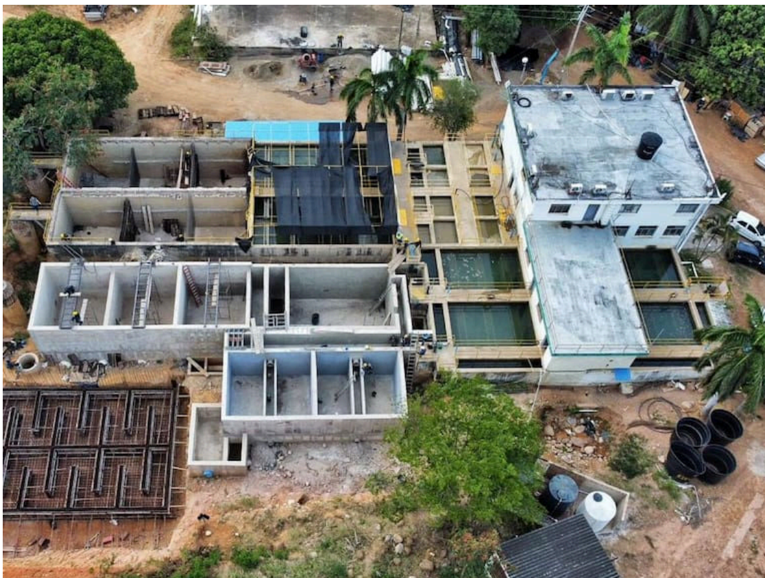
Planta de Tratamiento de Agua Potable La Gran Colombia / Foto: Aqualia
